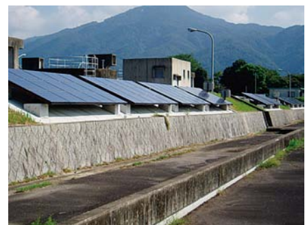
▲ 松ヶ崎浄水場の太陽光発電設備
